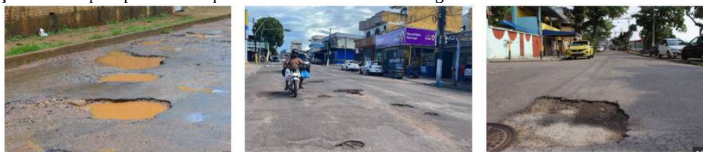
Figura 1 – Vias que apresentam deteriorações
