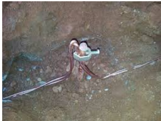
Fig.03-Conexão cabo haste em uma malha de terra
