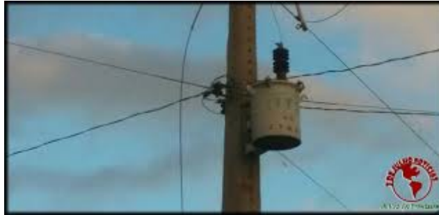
Fig. 32-Transformador em area rural
