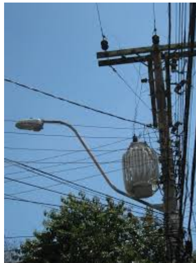
Fig. 28- Transformador trifásico em instalação urbana
