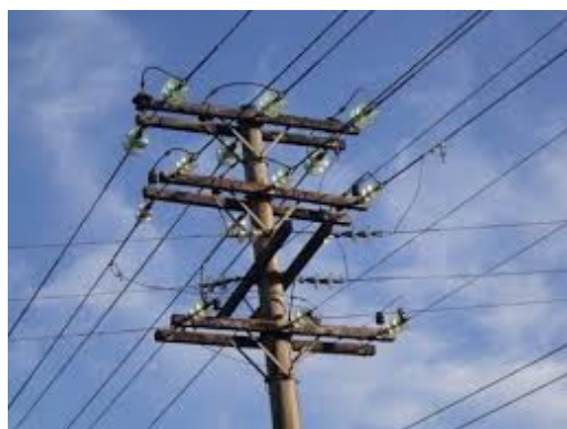
Fig.40-Estrutura em zona urbana para distribuição em 138kV
