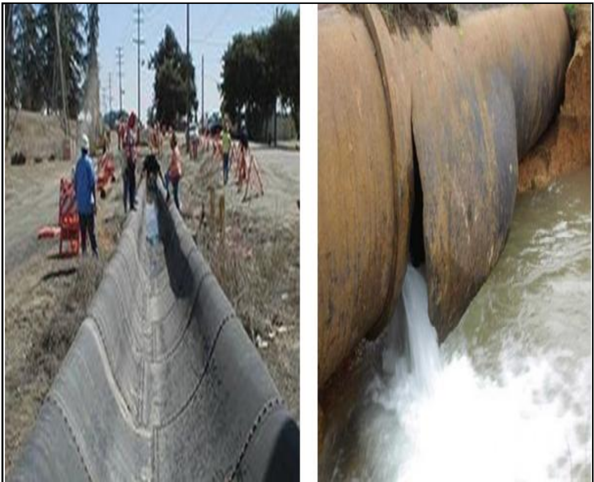
Figura 8. Colapso de adutoras causado pelo golpe de aríete em tubulações. ( https://br.pinterest.com/t4clube/ )
