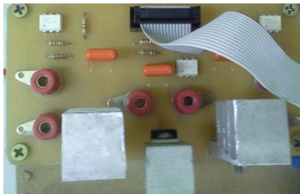
Figura 119 - Fotografia da placa da chave estática de transferência de topologia com tiristor. Fonte: Autor.
