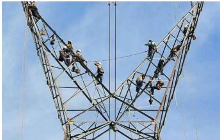
Figura 2.9 – A estatal Furnas Centrais Elétricas anunciou em 18/08/2010 que instalou os reforços nas 70 torres de transmissão da linha de transmissão que sai da hidrelétrica de Itaipu, em Foz do Iguaçu (PR), e chega à subestação de Ivaiporã (PR), linha que ocasionou falha de energia (“apagão”). Fonte: Furnas Centrais Elétricas.
