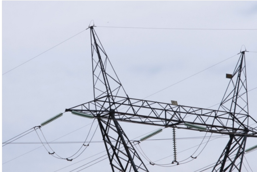
Figura 2.2 – Condutores energizados (na estrutura inferior) e cabos protetores pára-raios (nas pontas superiores) em detalhes de torre de linhas de transmissão da Eletrosul - Linha Londrina/Ivaiporã - Paraná - Brasil. Foto: o autor - Jun/2012
