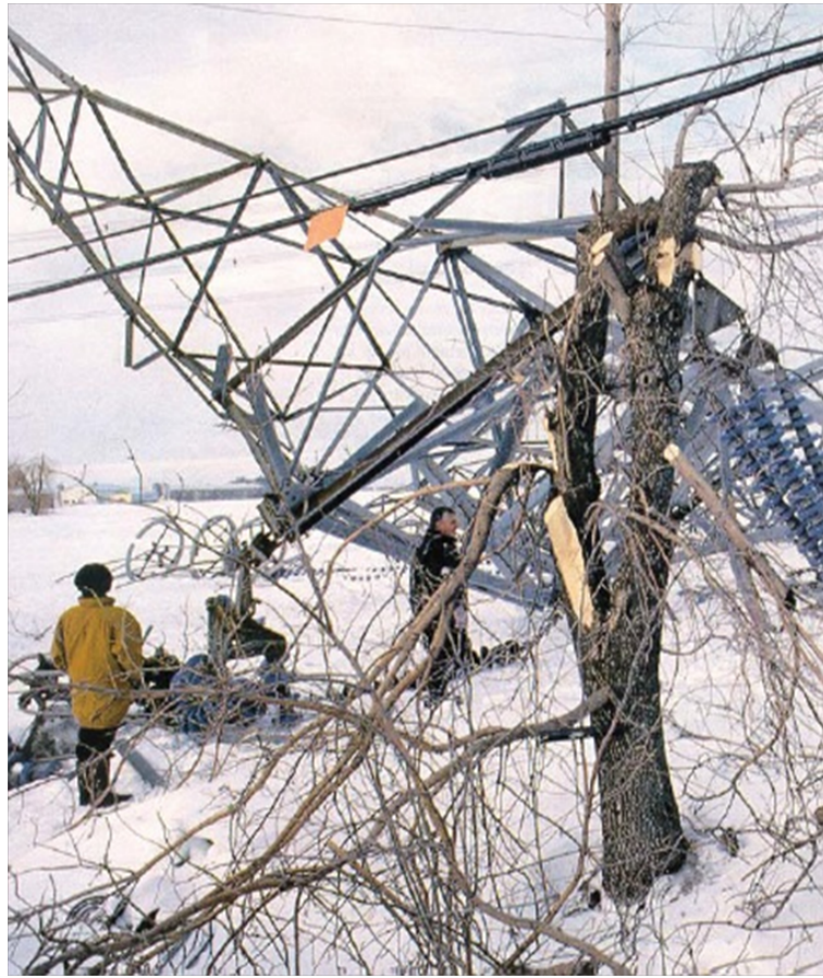
Figura 2.8 – Torres caídas de linhas de transmissão - Foto: Jeff Wang - Tyco Electronics.
