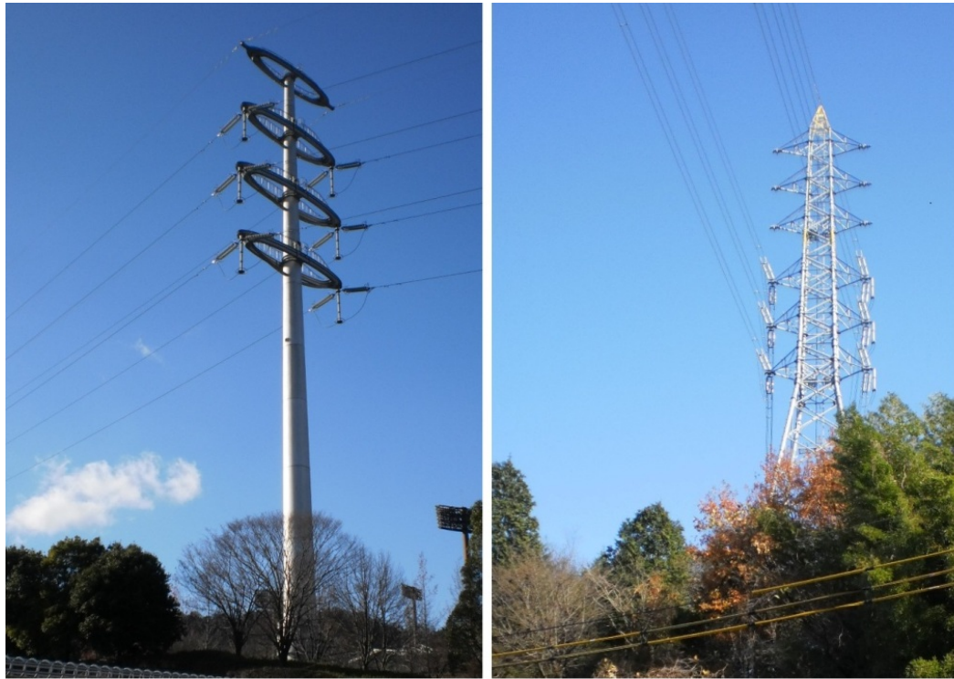
Figura 2.1 – Torres de Linhas de Transmissão - Hiroshima, Japão. Foto: o autor - Jan/2012
