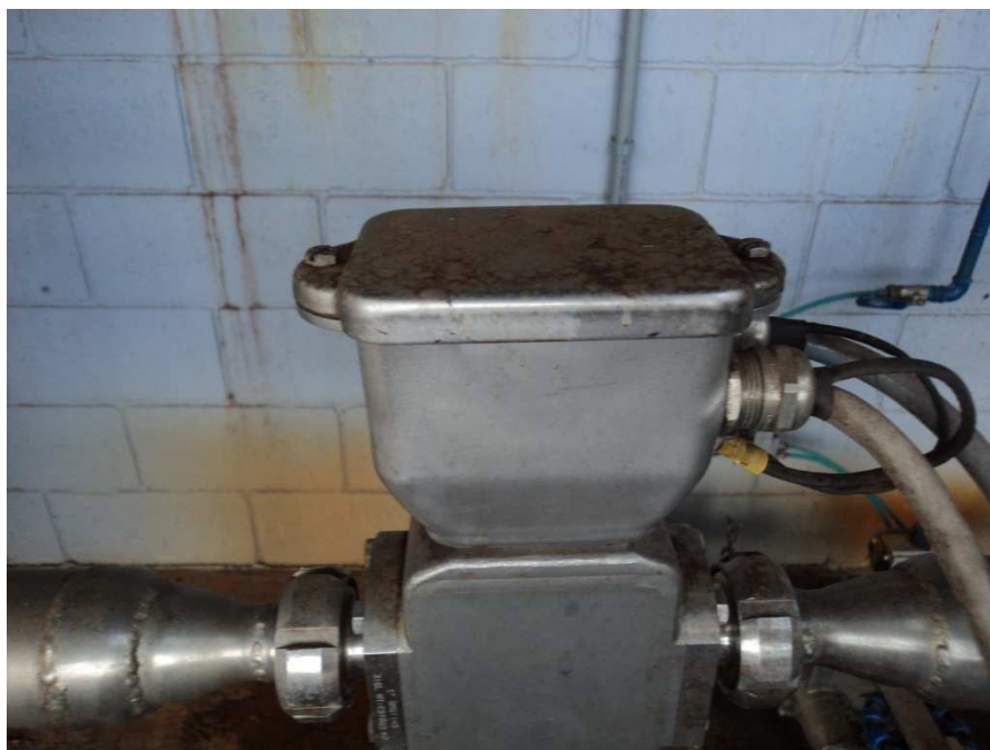
Figura 15 – Medidor de vazão do um sistema de bombeamento
