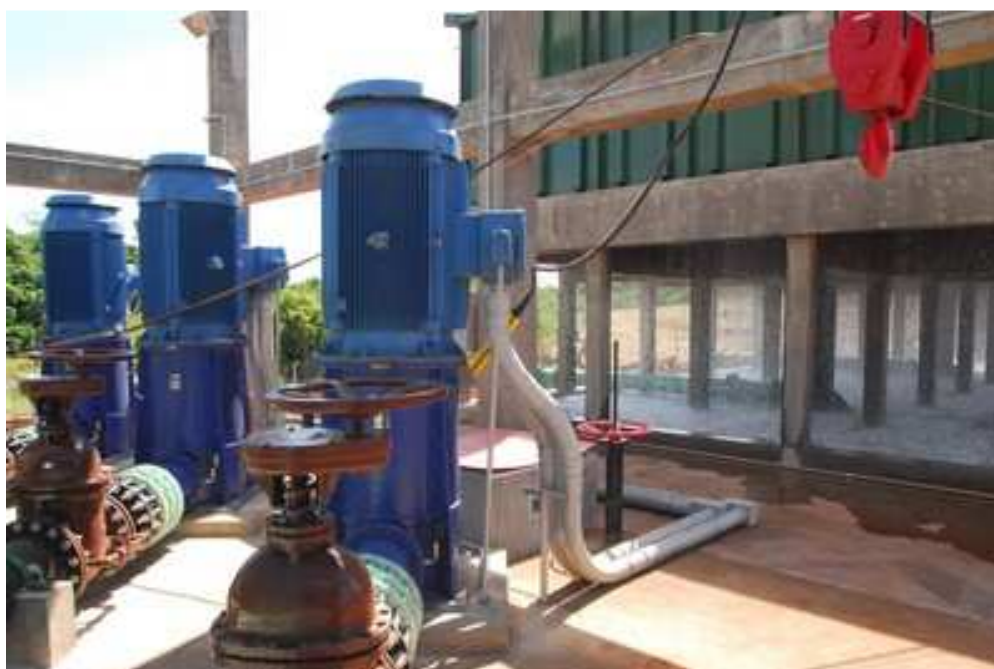
Figura 14 – Conjunto motobombas da estação elevatória Vivi Xavier.
