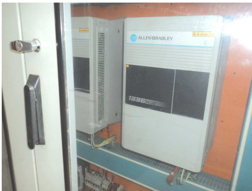
Figura 10 - Inversor de Frequência para acionamento de motobombas
