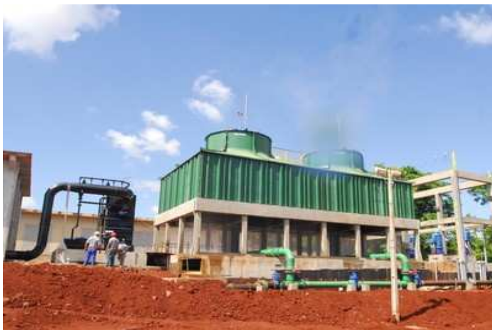
Figura 12 – Estação Elevatória de Vivi Xavier – Londrina/PR
