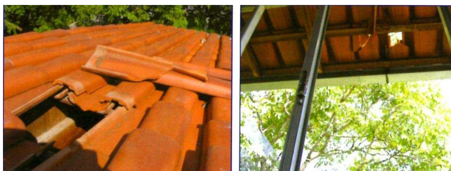
Figura 3.12: Detalhes do telhado por onde penetrou a descarga. Fonte: (ALVES, 2006)
