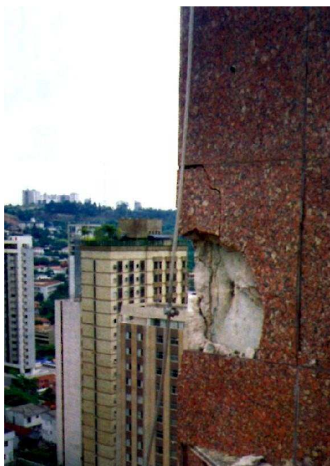
Figura 2.2: Ruptura de fachada por corrente de descarga atmosférica proveniente do sistema de descida do aterramento. Fonte:(ALVES, 2006)
